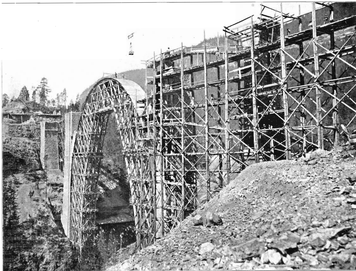
Abb. 28. Etagerengerüst an den rechtsufrigen Pfeilern und Lehrgerüst der Mittelöffnung des Wiesener Viadukts.
